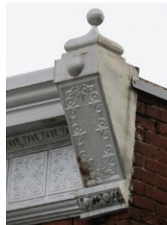
Détails de l'urne et de la console du 113-115, rue Blainville Ouest, Sainte-Thérèse
