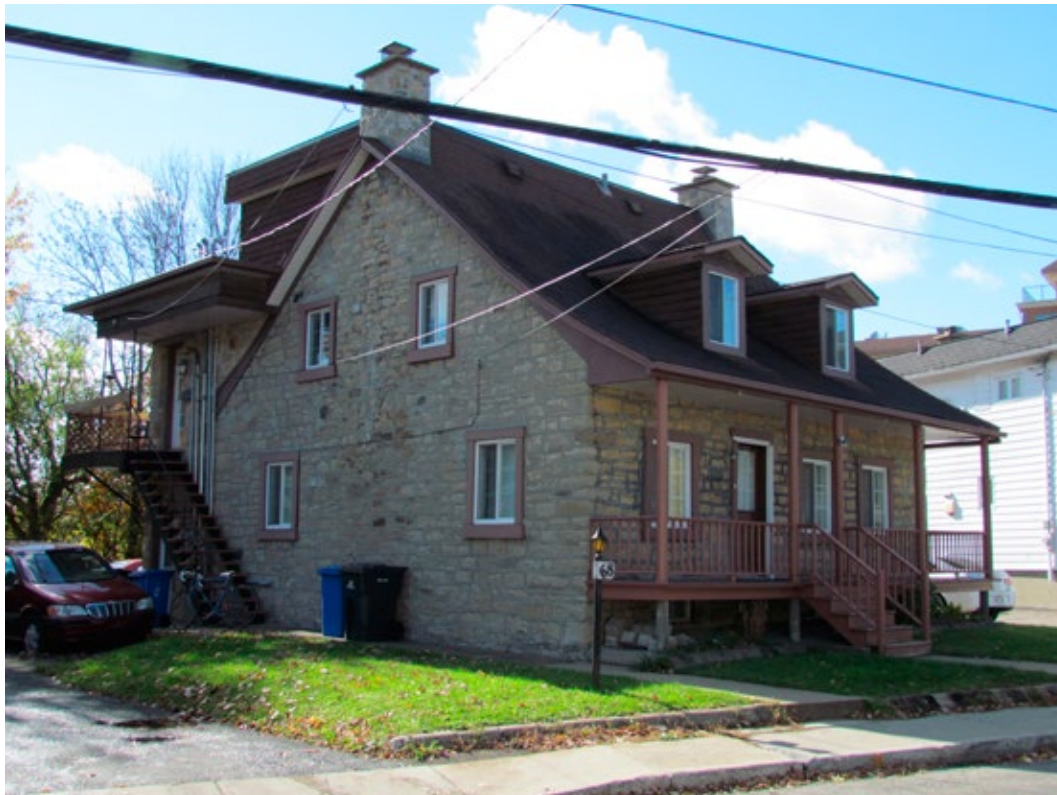
La maison Alfred-Dubois en 2014. En plus de la disparition du garde-corps à balustres, des aisseliers et des fenêtres à battants à six grands carreaux, une intervention inappropriée a été effectuée à l'arrière de l'édifice, changeant ainsi radicalement son profil. Les lucarnes, tout à fait acceptables pour ce genre d'édifice, ont été ajoutées; leur avant-toit est toutefois trop large.
